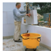
Mobilność w miejscu pracy
